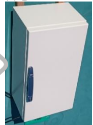
蓄電コントローラー
