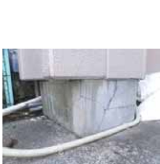
本社：土台の亀裂
