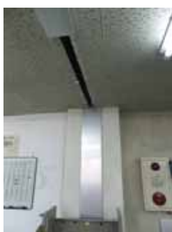
本社：建屋つなぎ目の剥離
