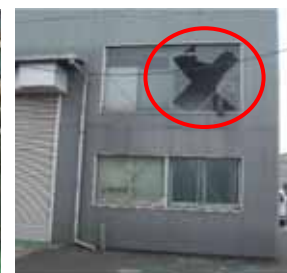
元町：窓ガラス破損
